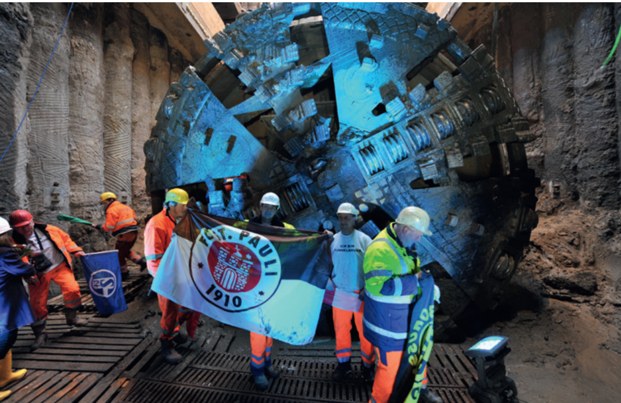
Die Bohrmaschine V.E.R.A. nach dem Durchstich der zweiten Tunnelröhre. Die Mineure verlassen die Steuerzentrale – jeder mit der Fahne seines Lieblingsvereins
