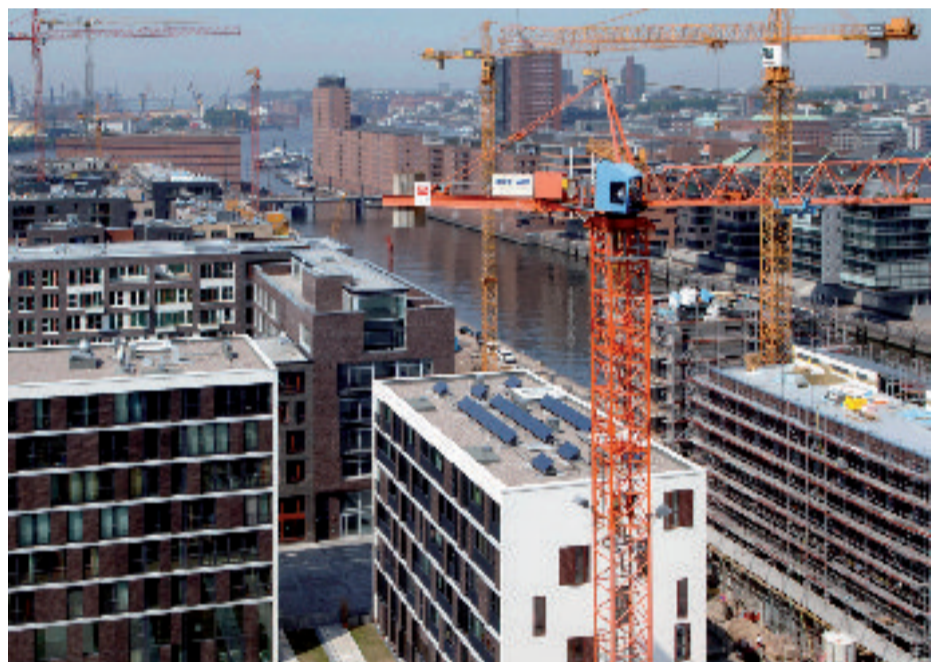
Die Südausrichtung am Dalmannkai ist prädestiniert für Solarenergienutzung, deren Fläche in der westlichen Hafencity mindestens 1.800 m 2 betragen wird und der Warmwasserversorgung der Wohnbauten dient
